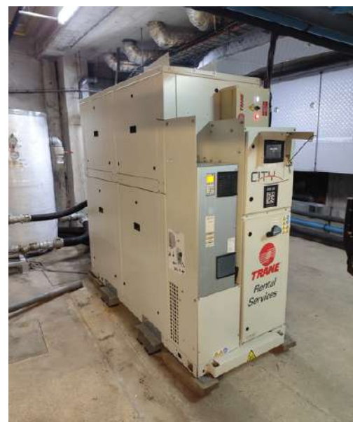
Bomba de calor
